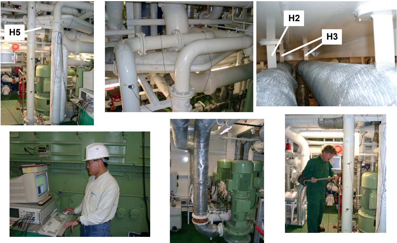
Abb. 3.13: Impact-Messung am Feuerlöschesystem
