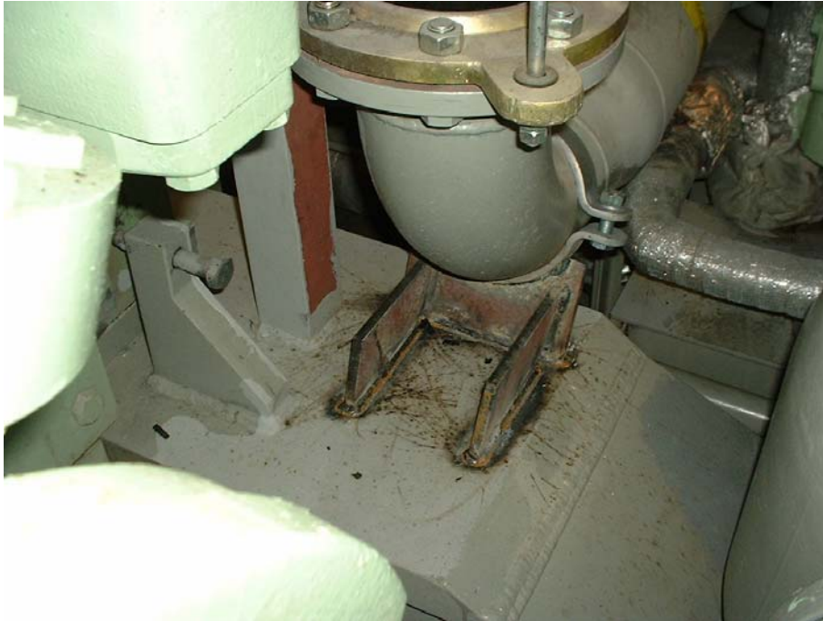
Abb. 1.3: Einzelanfertigung eines Rohrhalters zur Fixierung einer Hauptschmierölleitung
